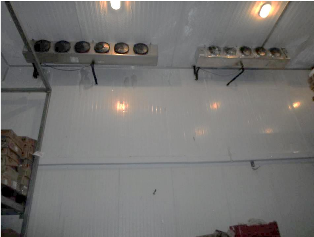
Figura 9. Instalación de cuartos fríos
