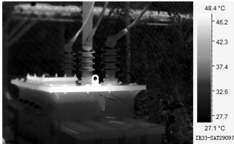
Figura 3. Termograma de un transformador trifásico
