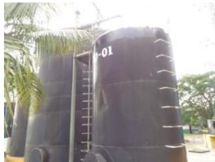
Figura 43. Tanques de líquidos
