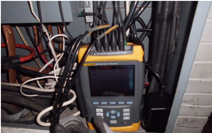
Figura 13. Equipo instalado en campo
