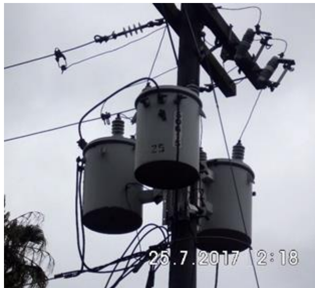
Figura 12. Banco de transformadores tipo poste
