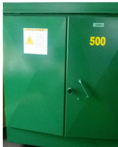
Figura 10. Transformador tipo pad-mounted
