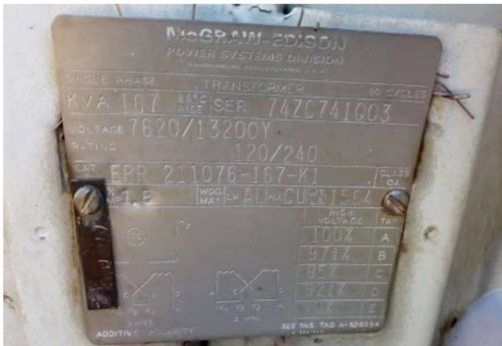
Figura 9. Placa de transformador
