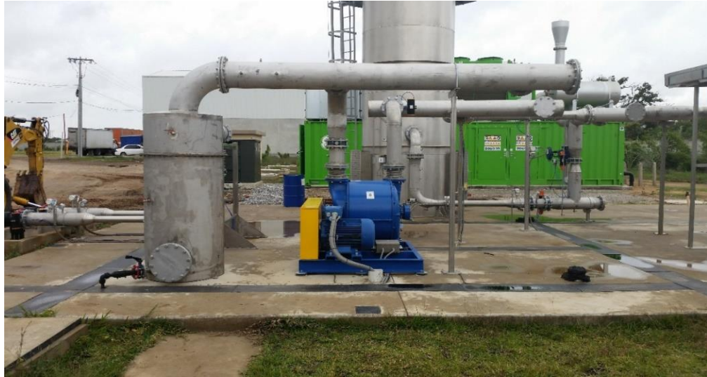
Figura 16. Tren de limpieza de biogás
