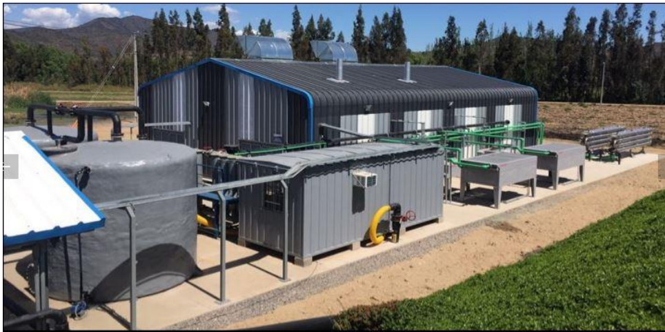
Figura 18. Tren de limpieza de biogás
