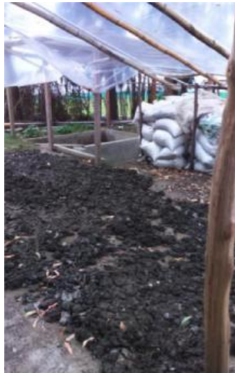
Figura 11. Segundo patio de secado del tratamiento primario de los lodos residuales, en la planta de efluentes de la Asociación Amigos del Lago
