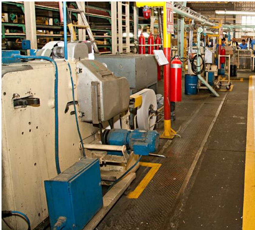
Figura 55. Motor eléctrico en línea C-148
