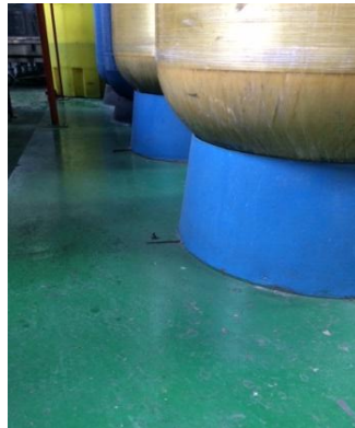
Figura 27. Base de filtros purificadores
