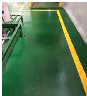
Figura 28. Piso de planta de producción
