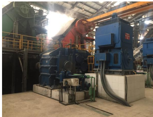
Figura 21. Motor DC acoplado con reductor de alta, molino 4 tándem A
