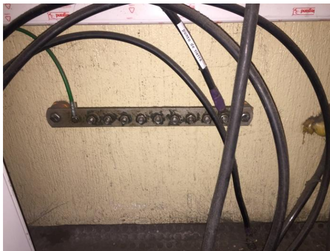
Figura 87. Barra de tierra área de molinos
