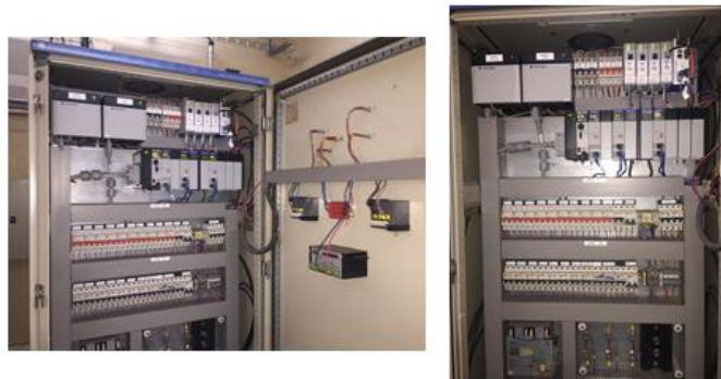
Figura 72. Módulo de red 1756-EN2TR instalado en su chasis
