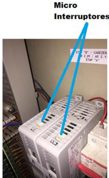
Figura 128. Interruptores módulo ETAP
