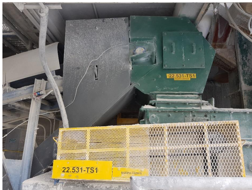
Figura 114. Trituradora de martillos, línea 1 de cal
