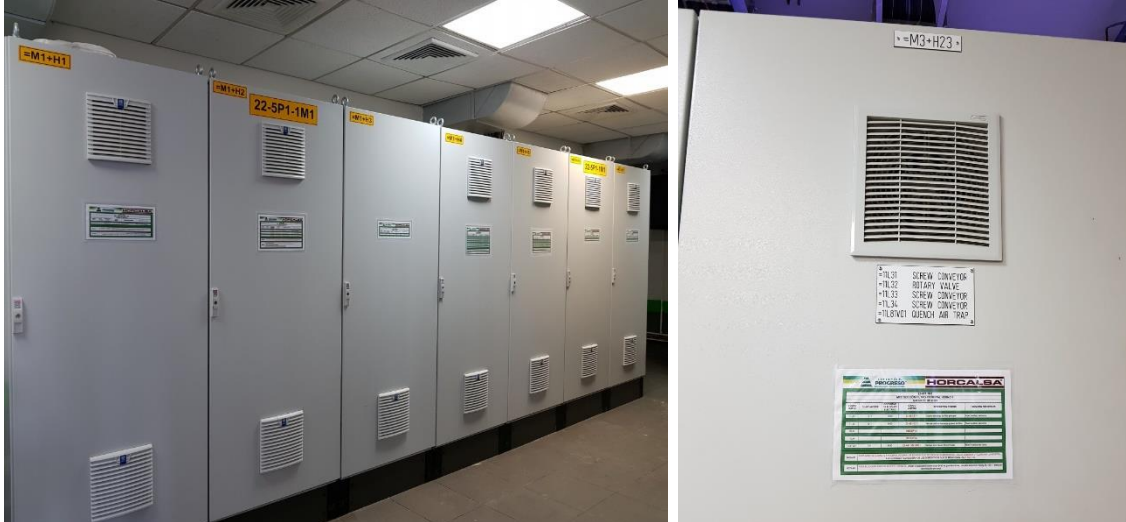
Figura 79. Paneles eléctricos en planta de cal
