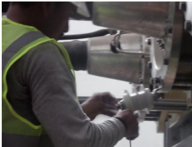
Figura 63. Instalación de resistencias no lineales
