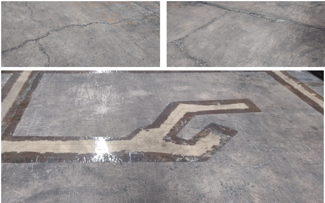
Figura 13. Imágenes de cimentación dañada y reparada
