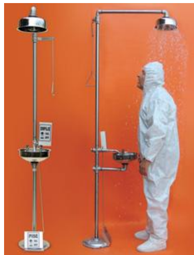
Figura 9. Fuentes de descontaminación con duchas y lavajos
