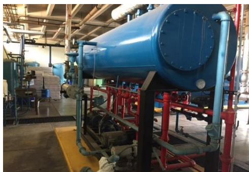
Figura 18. Tanque del retorno de condensado
