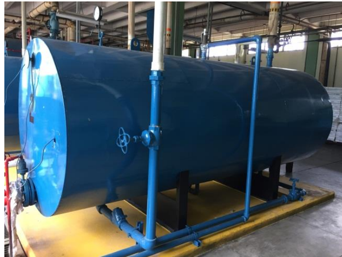
Figura 19. Tanque para agua caliente
