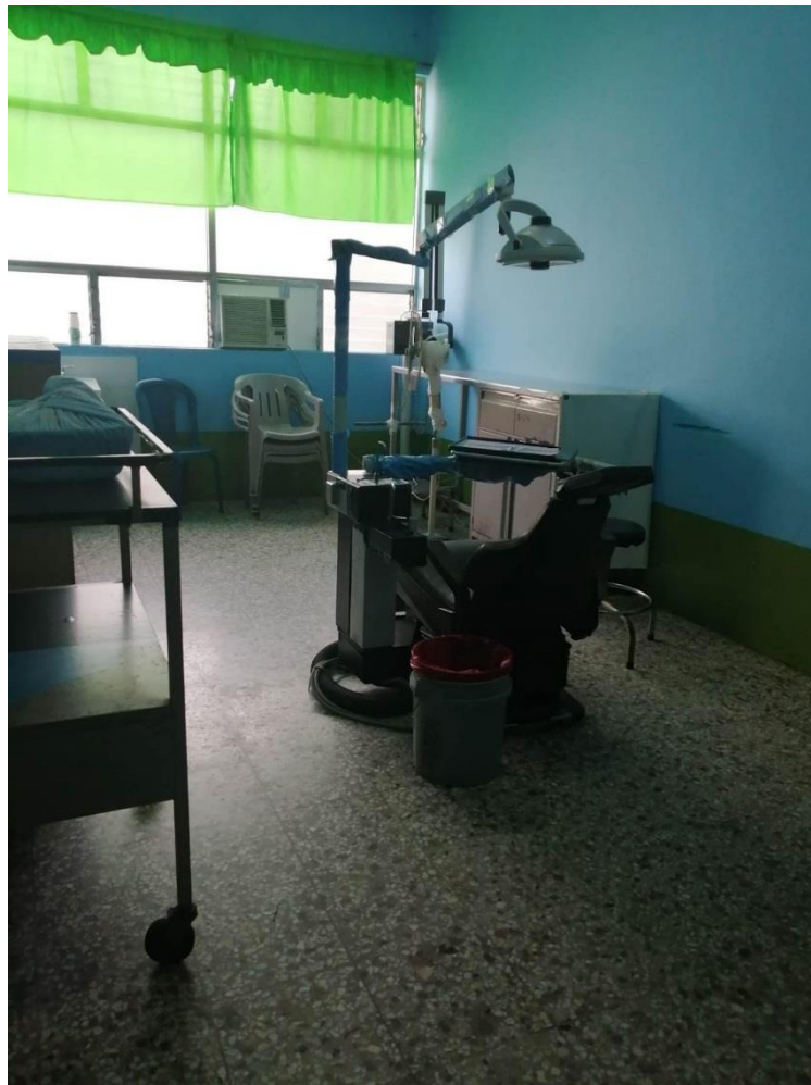
Aire acondicionado instalado en la clínica de la consulta externa del Hospital Nacional de Retalhuleu.
