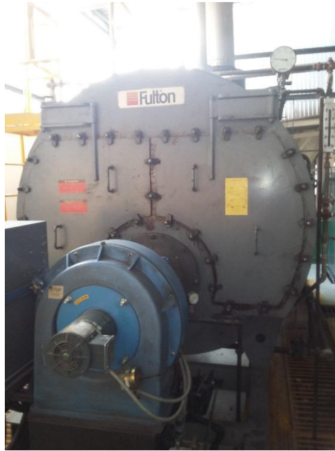
Figura 8. Caldera Fulton Boiler
