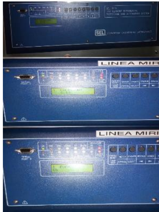
Figura 181. Relé de línea de transmisión con datos de interrupción
