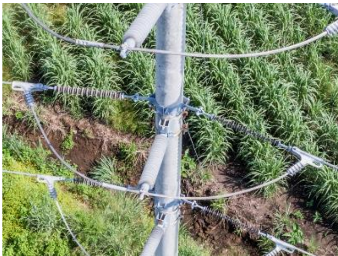
Figura 152. Puente eléctrico en línea de transmisión
