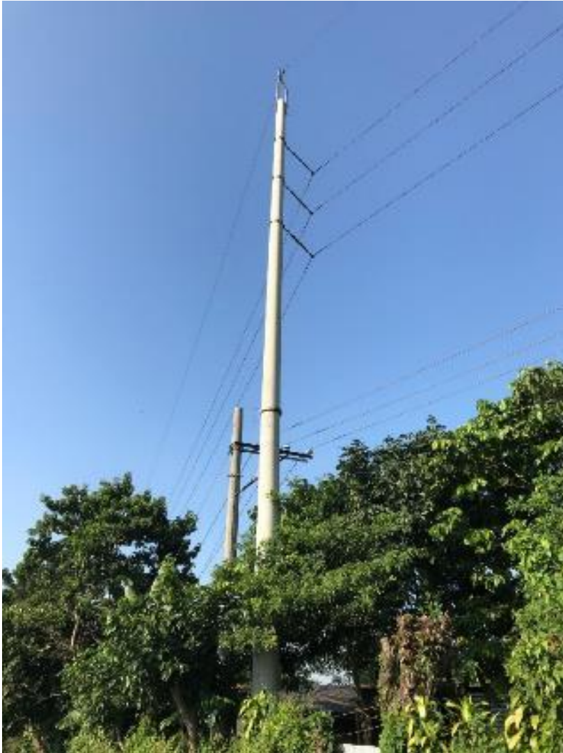
Figura 113. Monopolo de concreto de 24 metros clase 2000 en configuración III con bayoneta
