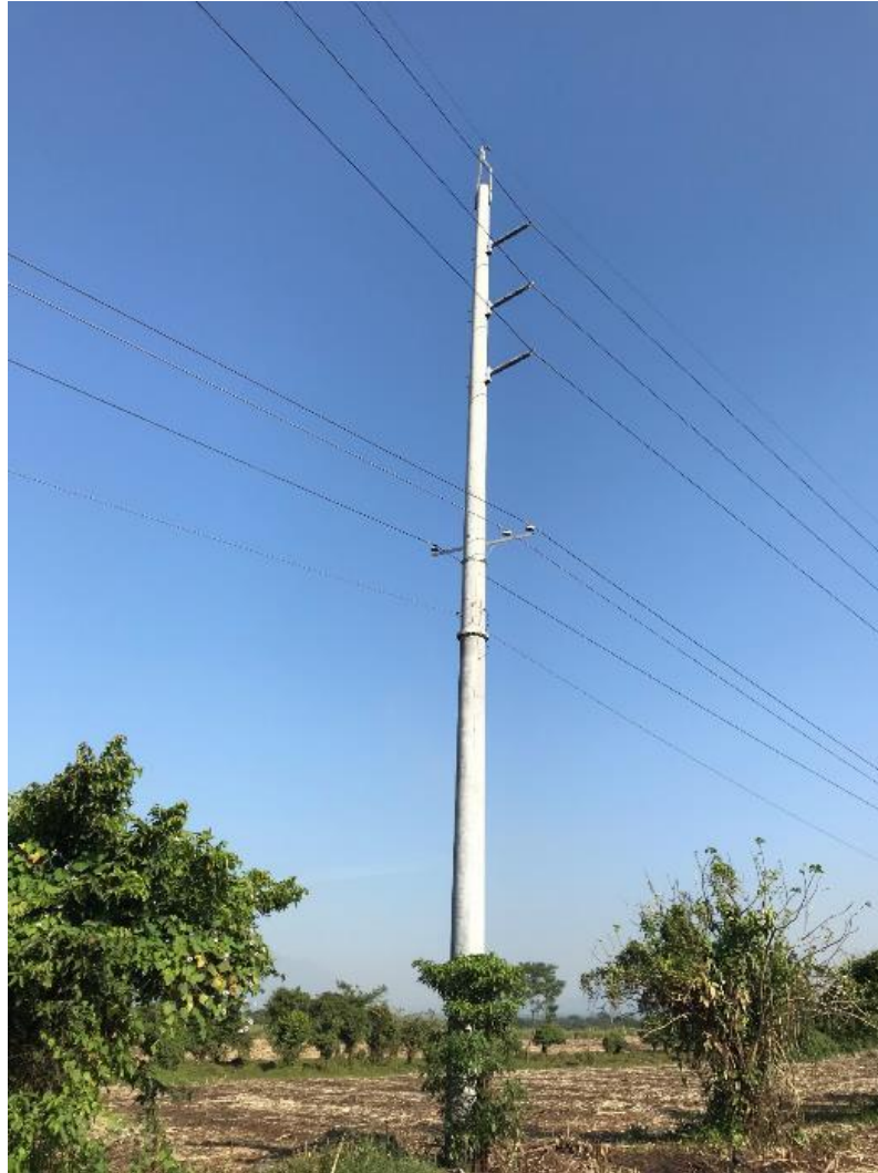
Figura 104. Monopolo de hormigón de 24 metros clase 2000 en configuración I
