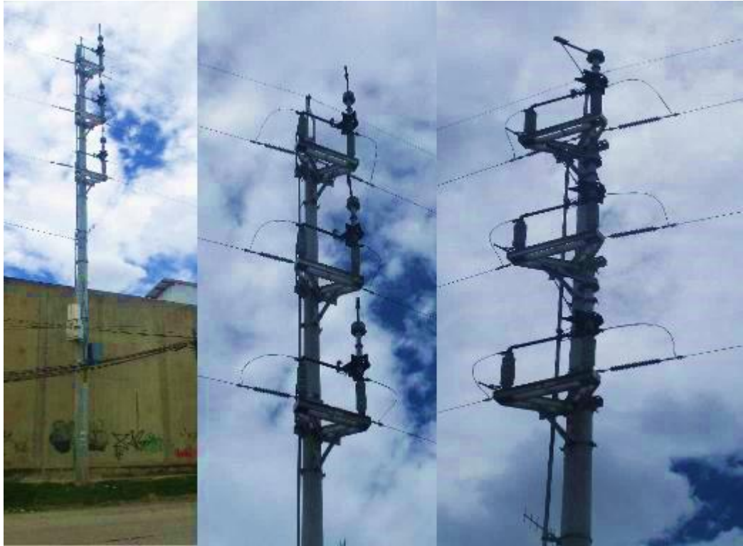
Figura 99. Seccionador trifásico automatizada marca SEECO
