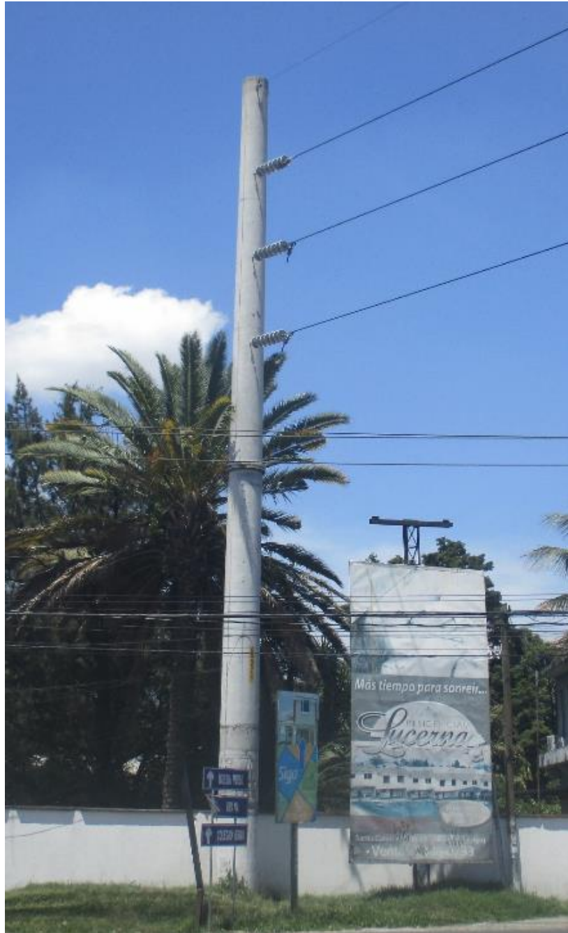
Figura 101. Configuración de remate final para monopolos de líneas de transmisión de 69 kV
