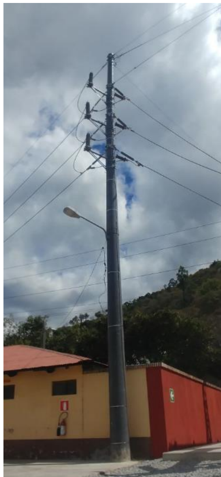
Figura 12. Monopolo de resina de 21 metros de altura y clase 4 000 lbf
