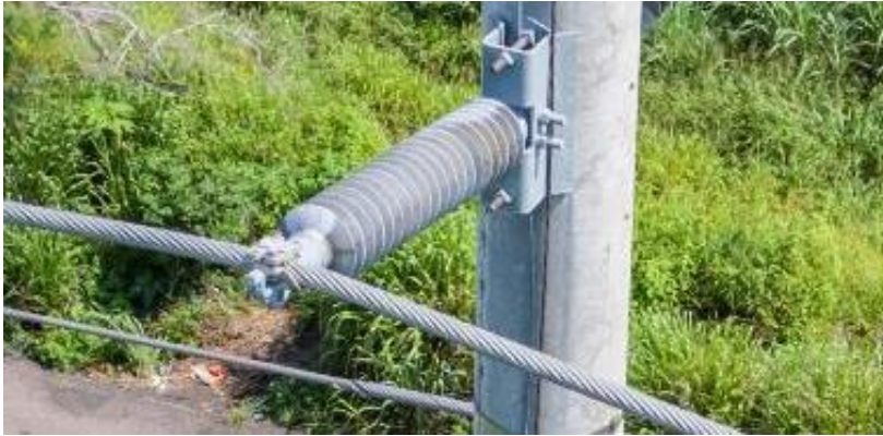
Figura 182. Aislador dañado por descarga atmosférica
