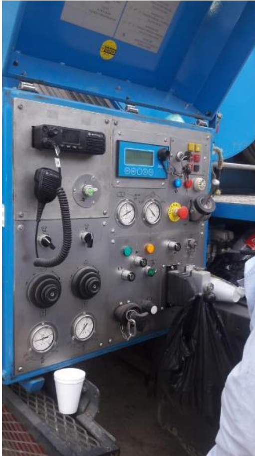
Figura 143. Tablero de máquina de tendido
