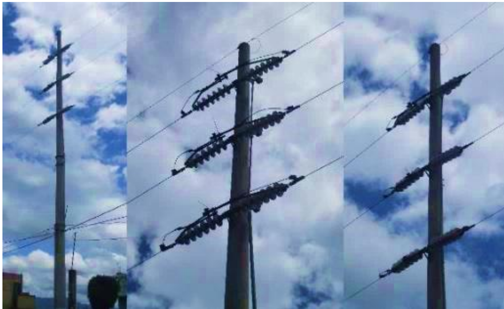
Figura 97. Seccionador de aire trifásico en línea marca KPF en tangente
