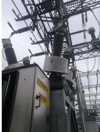
Figura 35. Ubicación física de CTs dentro de un interruptor SIEMENS
