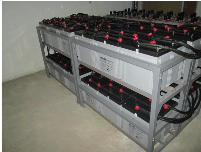
Figura 38. Banco de baterías montados sólidamente
