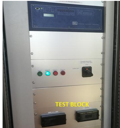
Figura 56. Test block ABB (módulo de pruebas) para un campo de línea
