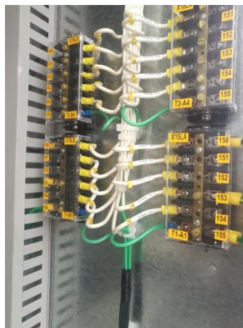
Figura 54. Bornes del secundario del CT que está ubicando dentro de interruptor para 69KV
