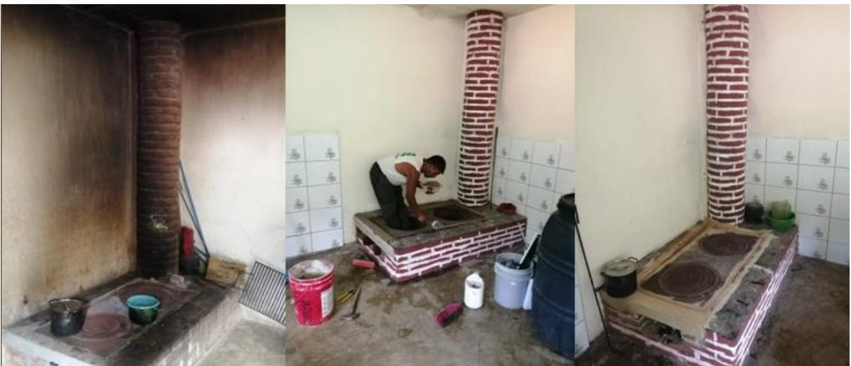
Fuente: Proyecto comunitario: Remodelación cocina de la Escuela Oficial Urbana Mixta El Calvario. Antes, durante y después. EPS 2019.
