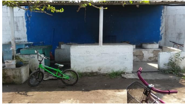
Fotografía 2. Cocina escolar en deterioro
