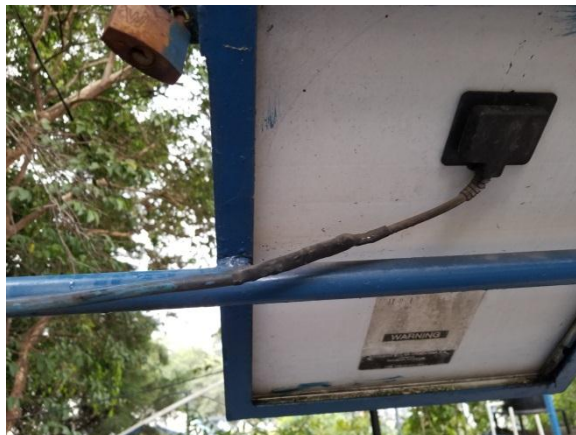
Figura 38. Panel fotovoltaico izquierdo, después
