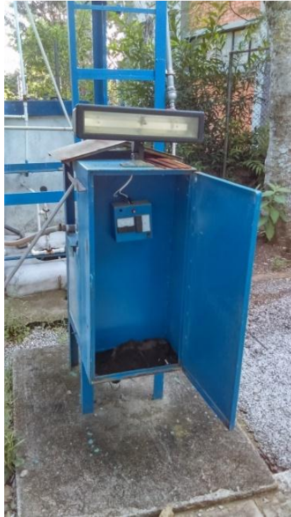
Figura 2. Componentes eléctricos, condición inicial
