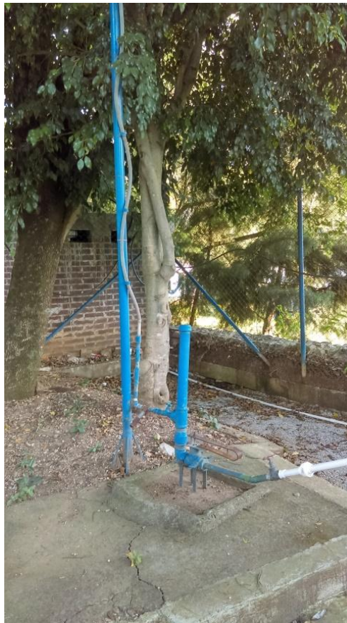
Figura 7. Ariete hidráulico, condición inicial
