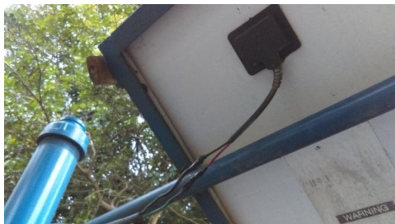
Figura 36. Panel fotovoltaico izquierdo, antes
