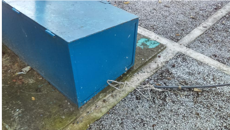
Figura 27. Contenedor de paneles fotovoltaicos
