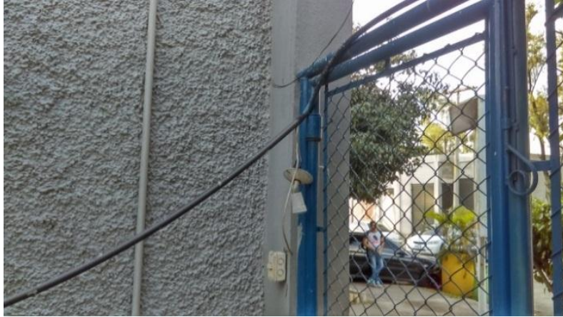
Figura 10. Sistema de iluminación 1/3, condición inicial
