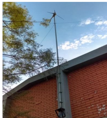
Figura 6. Generador eólico, condición inicial
