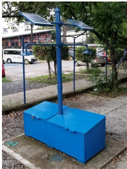
Figura 43. Paneles fotovoltaicos, después
