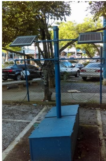
Figura 4. Paneles fotovoltaicos, condición inicial
