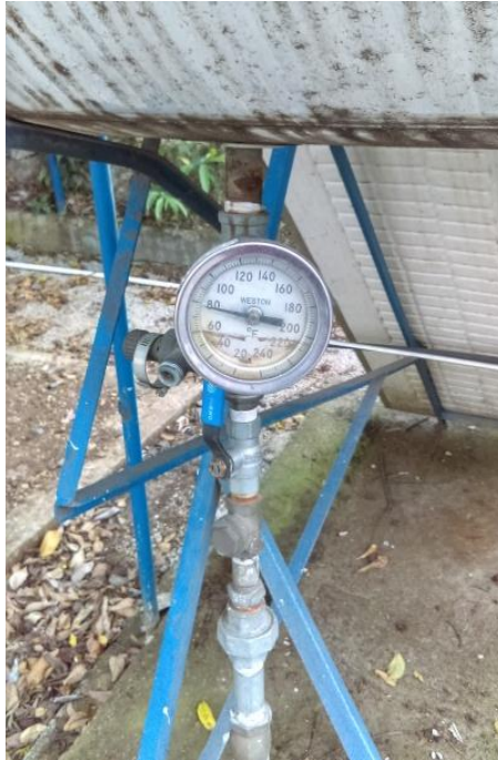
Figura 9. Medidor de temperatura, condición inicial
