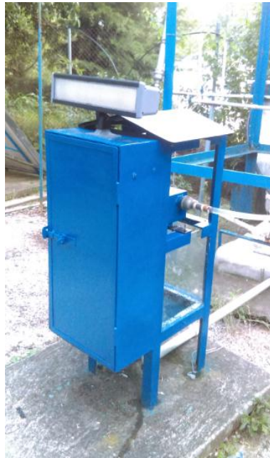
Figura 33. Turbina Pelton finalizada
