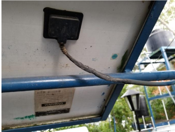
Figura 37. Panel fotovoltaico derecho, después
