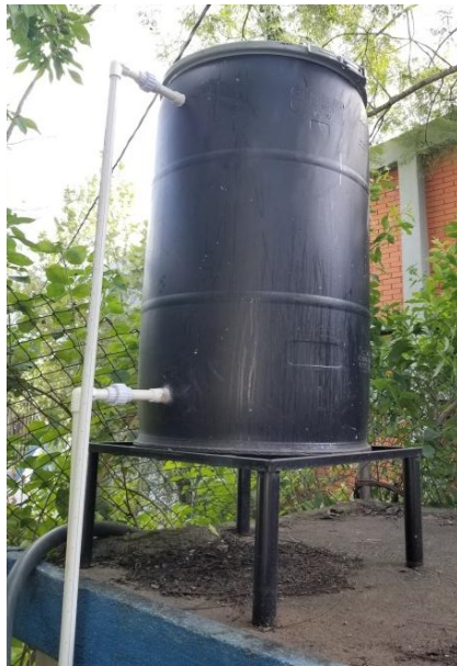
Figura 54. Tanque auxiliar y uniones universales
