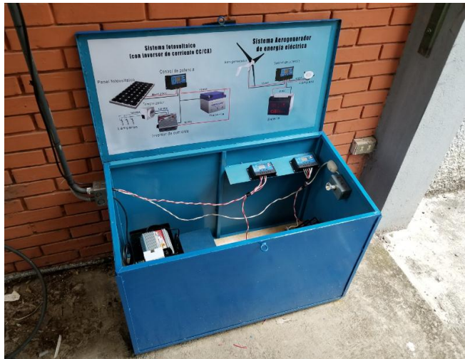
Figura 66. Contenedor instalado de sistema fotovoltaico y aerogenerador
