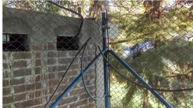
Figura 12. Sistema de iluminación 3/3, condición inicial
