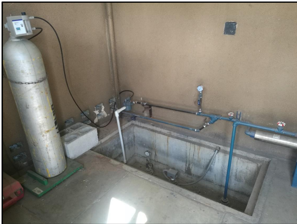
Figura 9. Sistema de cloración
