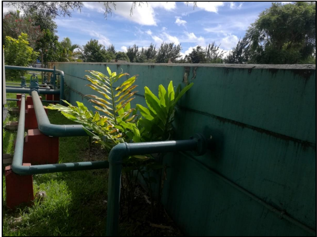
Figura 22. Cisterna o tanque de almacenamiento de agua
