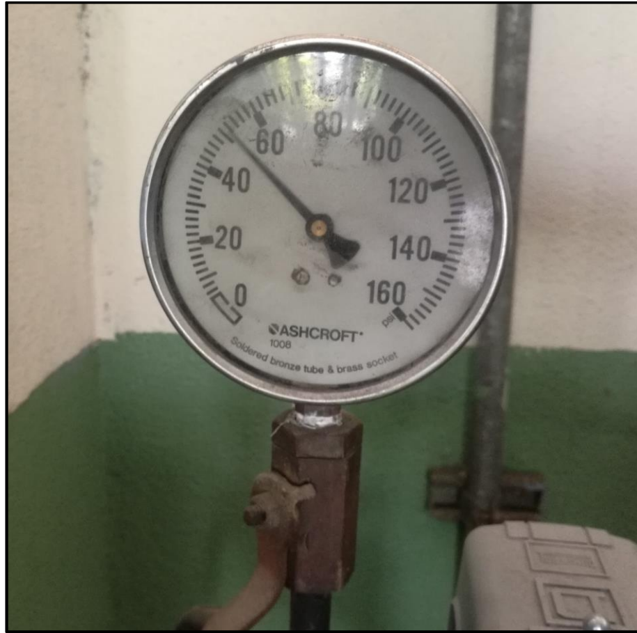
Figura 17. Manómetro de la estación de bombeo
