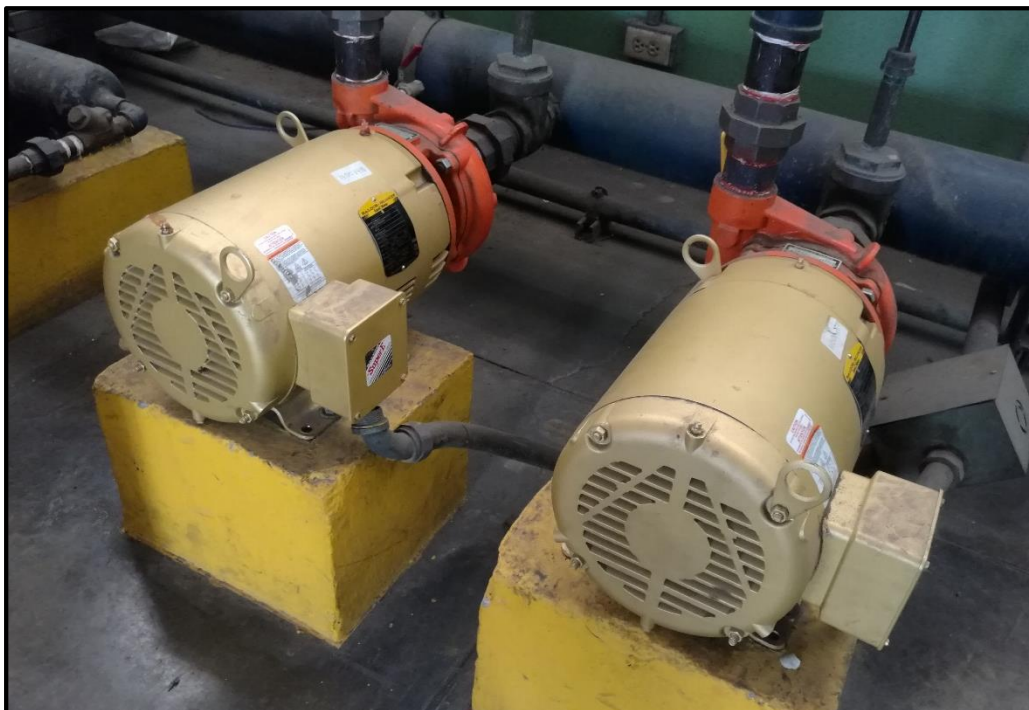
Figura 8. Sistema de bombeo de contención
