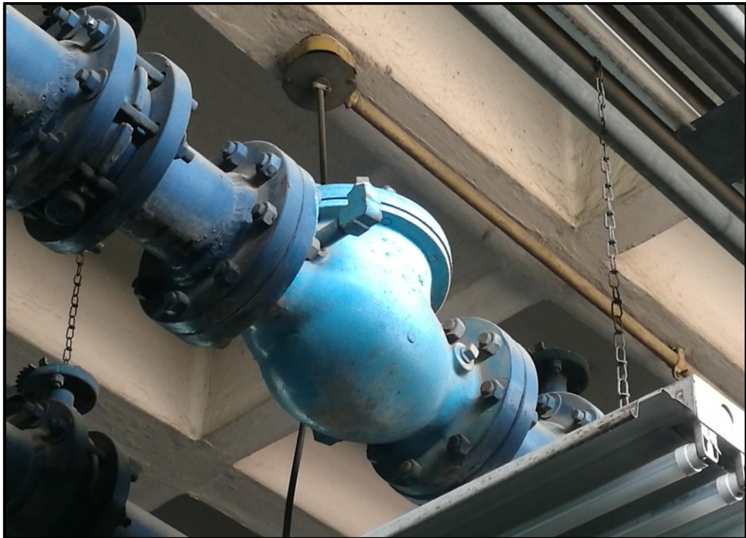
Figura 34. Válvula reguladora de presión fuera de servicio
