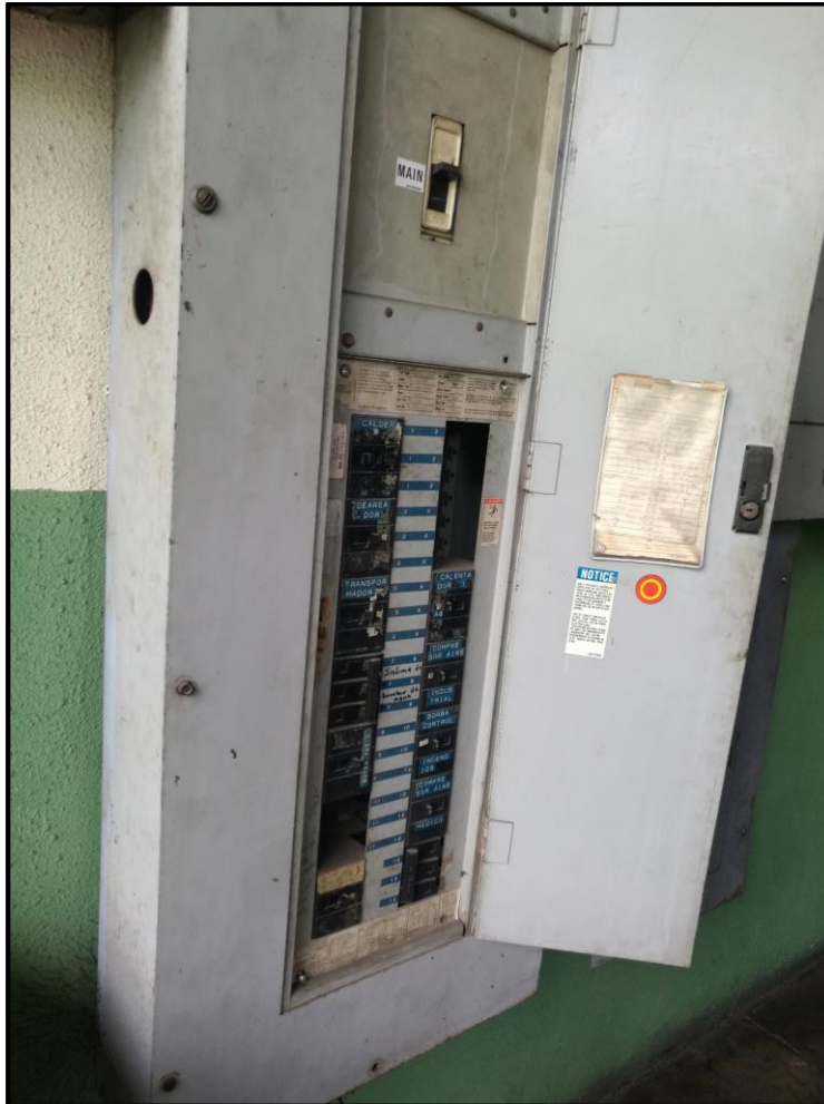
Figura 19. Flipón principal – casa de máquinas
