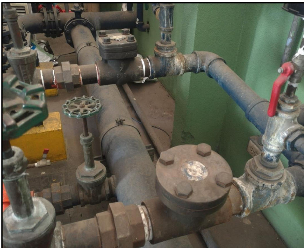
Figura 15. Válvula de retención a la salida de las bombas centrífugas
