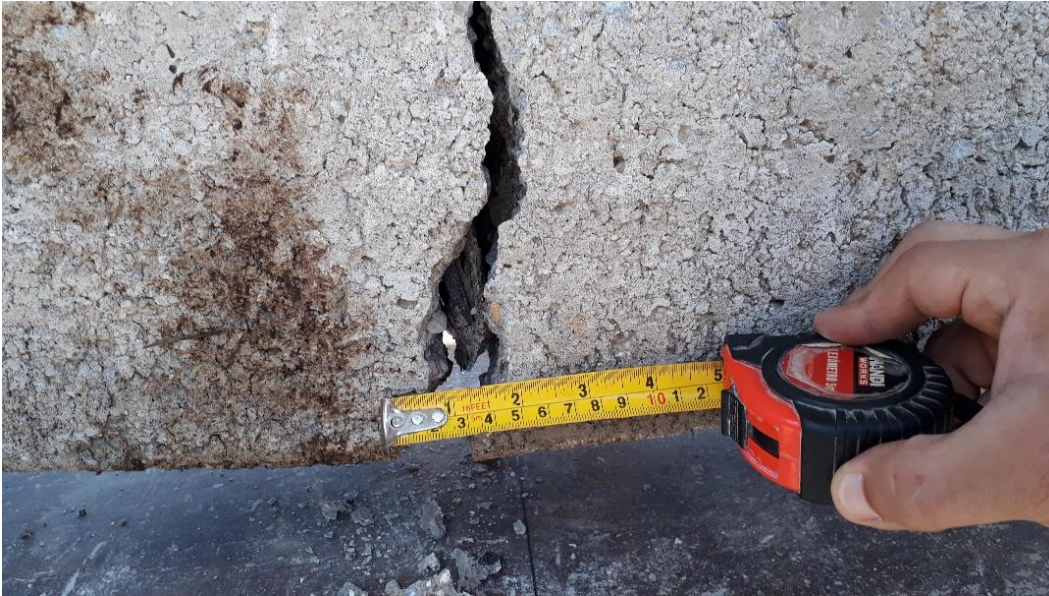
Figura 39. Medición de grieta en elemento viga por esfuerzo a flexión
