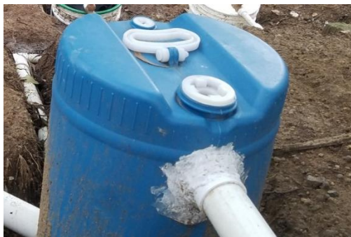
Figura 5. Tanque de captación
