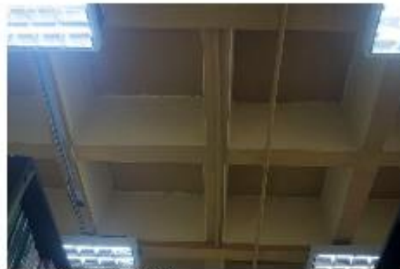
2. CONCRETO SUPERPOSICIÓN DE PINTURA CUBIERTA
