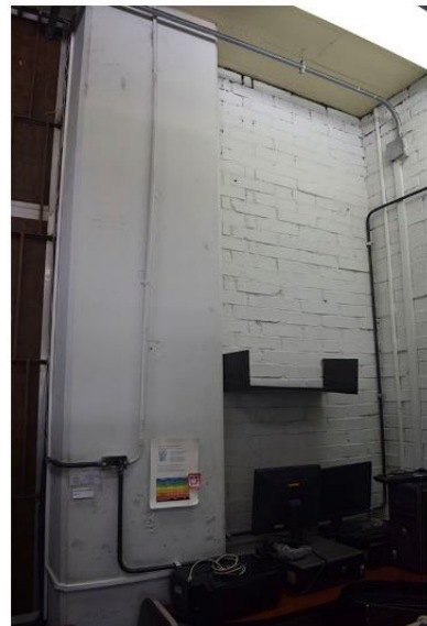
4. CONCRETO / LADRILLO SUPERPOSICIÓN DE PINTURA COLUMNA / MURO
