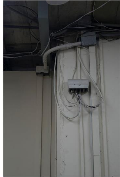
1. INSTALACIONES COLOCACIÓN INADECUADA COLUMNA / CUBIERTA
