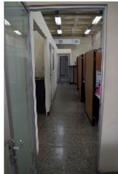
4. TABLAYESO ALTERACIÓN DEL ESPACIO MUROS
