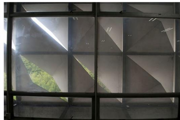
4. VIDRIO / ALUMINIO DESGASTE / OXIDO MURO
