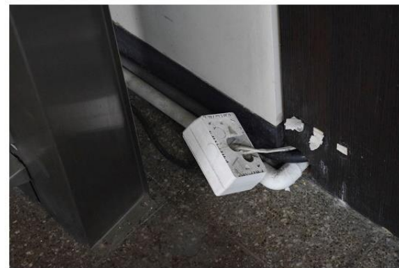
2. INSTALACIONES INADECUADA COLOCACIÓN COLUMNA
