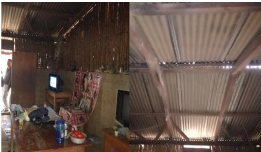
Figura 16. Estado de puertas y techo de la vivienda 4
