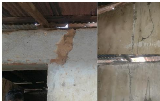
Figura 3. Vivienda 1, grietas en los muros
