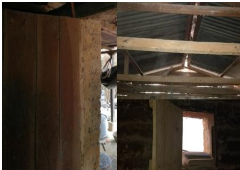
Figura 12. Estado de puertas, ventanas y techo de la vivienda 3
