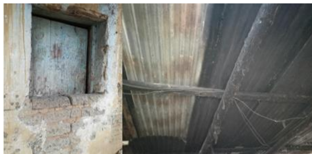
Figura 4. Deterioro de la vivienda 1
