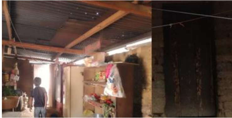
Figura 8. Deterioro de puertas, ventanas y techo de la vivienda 2
