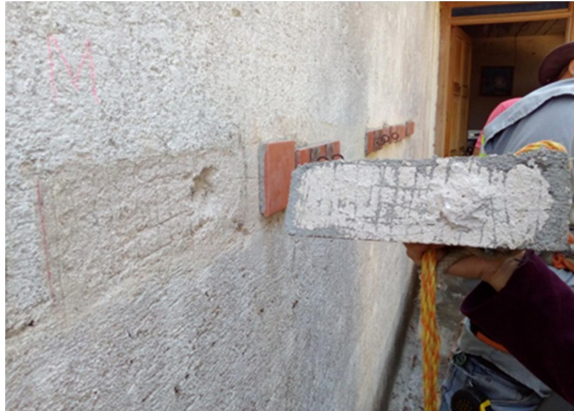
Figura 60. Falla cohesiva en el soporte, mortero 2 (falla D)
