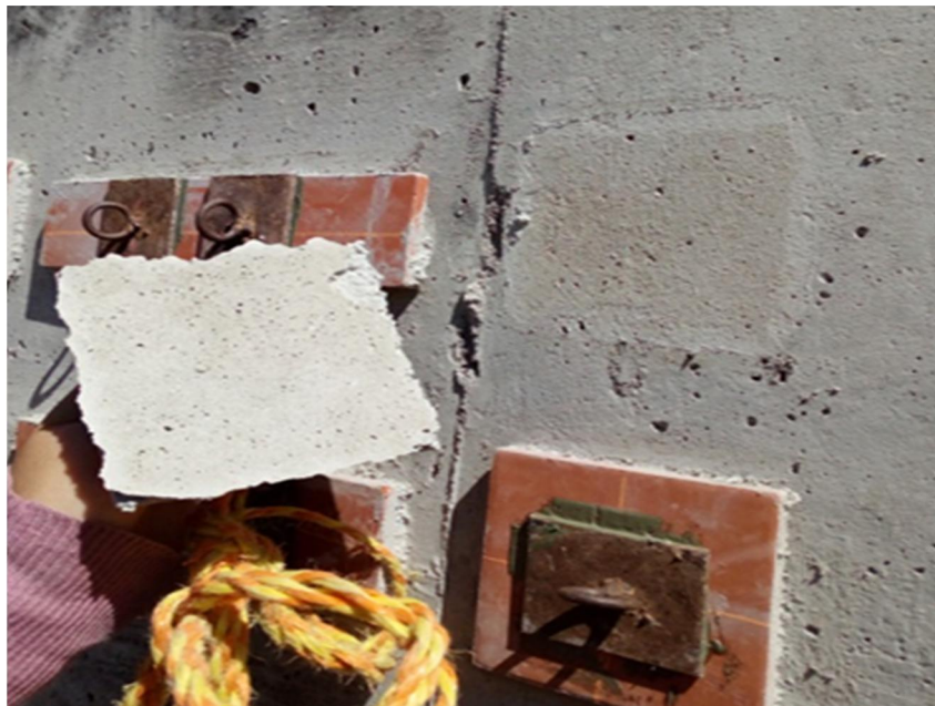
Figura 61. Falla adhesiva entre la interfaz del adhesivo y el soporte, mortero 2 (falla A)
