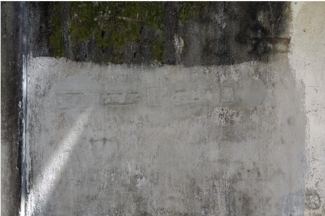
Figura 48. Superficie 6, repello en condiciones de humedad
