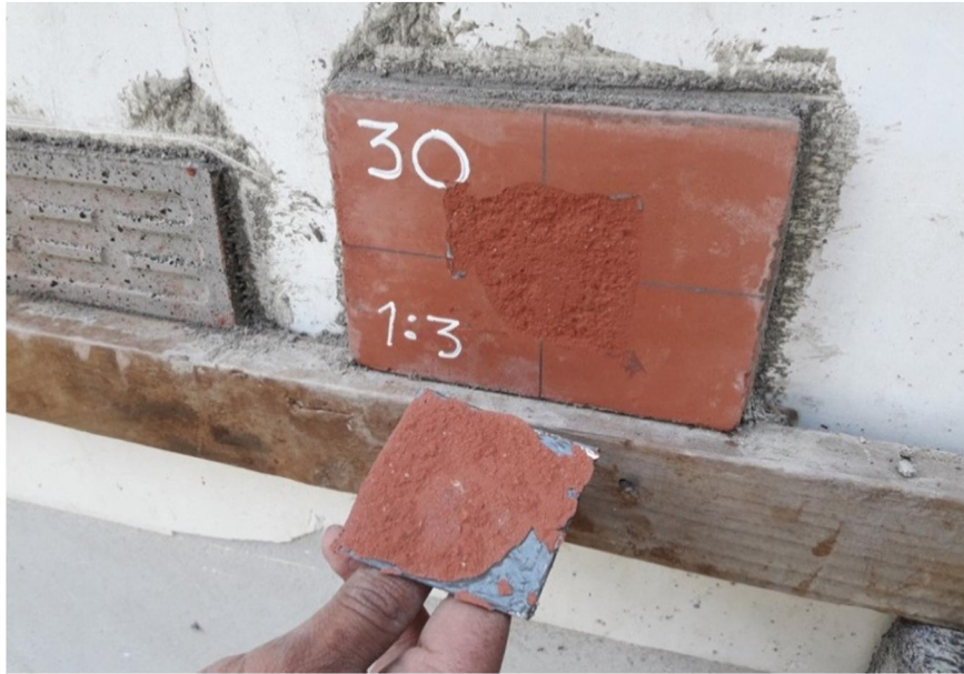
Figura 66. Falla cohesiva en el elemento cerámico, mortero 4 (falla E)
