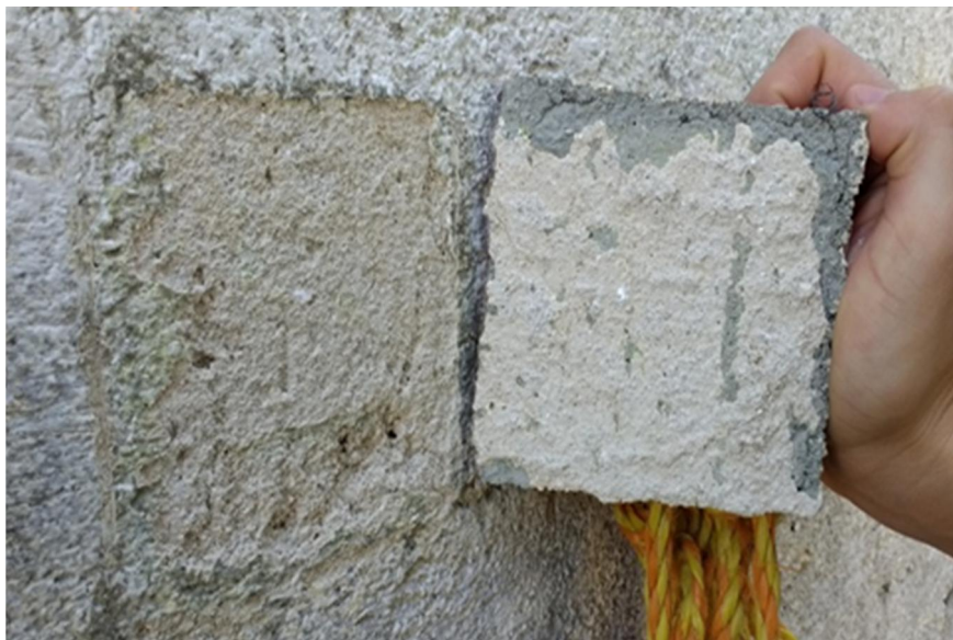
Figura 59. Falla cohesiva en el soporte, mortero 1 (falla D)
