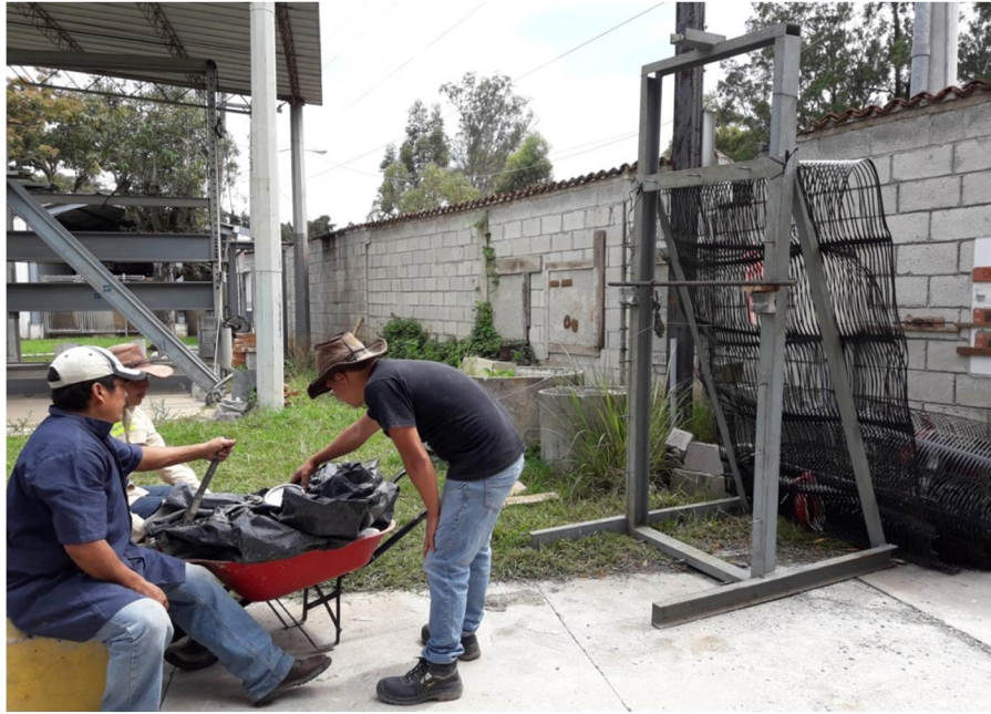
Figura 55. Aplicación de carga perpendicular a la fachaleta y lectura del dinamómetro durante el ensayo de adherencia
