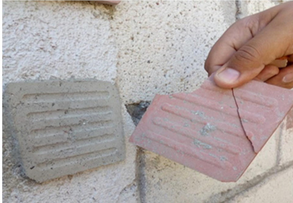
Figura 57. Falla adhesiva entre la interfaz del adhesivo y el elemento cerámico, mortero 1 (falla B)
