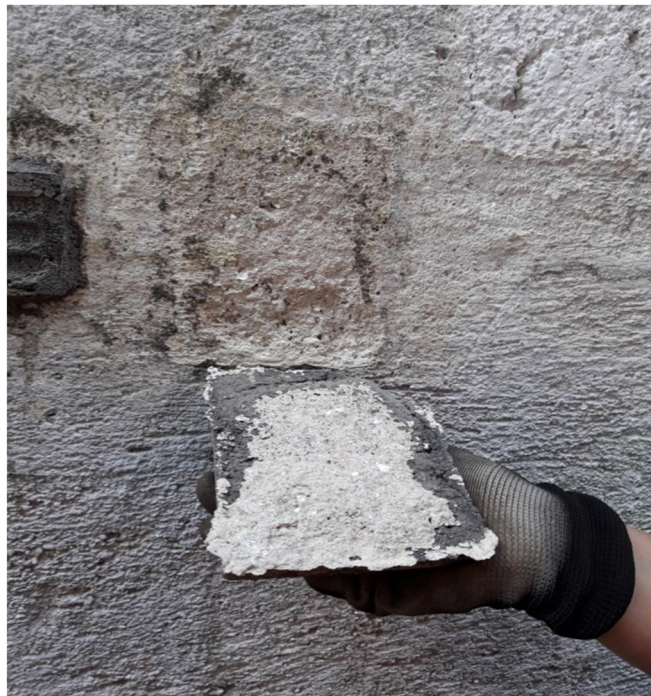
Figura 63. Falla cohesiva en el soporte, mortero 4 (falla D)
