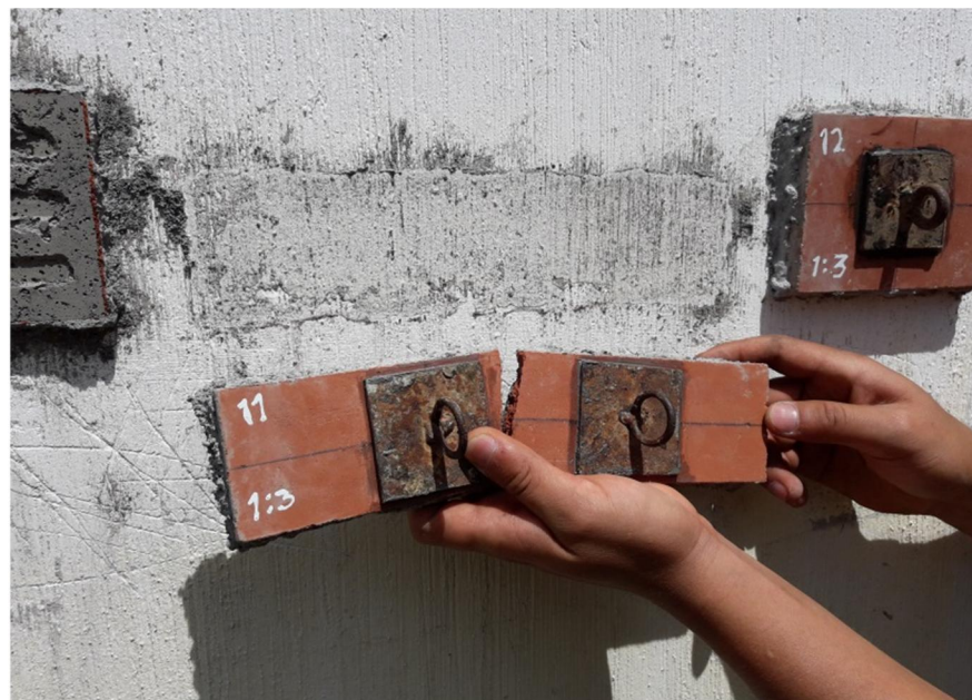
Figura 65. Falla adhesiva entre la interfaz del adhesivo y el soporte, mortero 4 (falla A)
