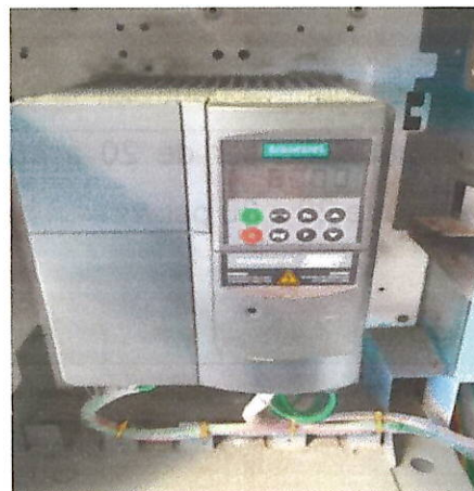
Figura 54. Variador de bomba de loop
