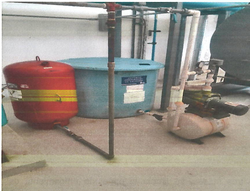
Figura 57. Tanque de salmuera y bomba
