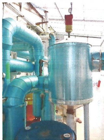
Figura 3. Tanque de expansión
