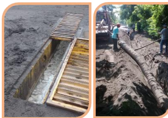
Fotografía # 71. Tubería para drenajes de agua pluvial. Sipacate, Escuintla. Fuente: André Casado, 2019
