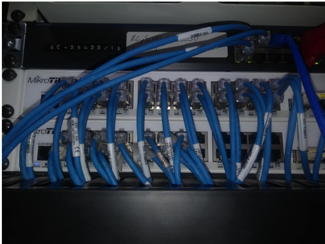
Figura 25. Cableado estructurado del conmutador Juniper ECyS_NO_1.203_JU
