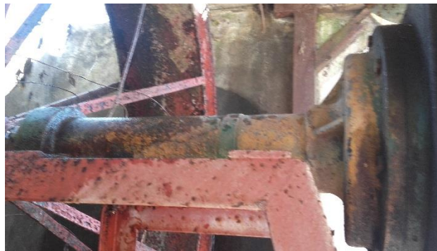
Figura 48. Chumacera de bomba Rochfer MS-89
