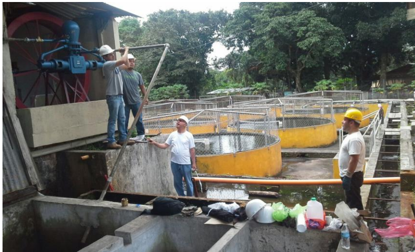
Figura 105. Fotografía de la verificación de la tubería de succión
