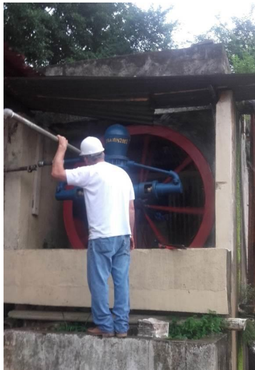
Figura 113. Puesta en función de bomba hidráulica de tipo reciprocante marca Rochfer, modelo MS-89, accionada por rueda de cangilones hidráulicos
