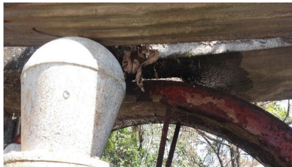
Figura 46. Fotografía de obstrucción de canal de entrada para rueda de cangilones hidráulicos
