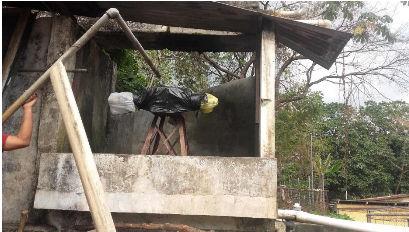
Figura 69. Fotografía de protección del equipo durante su reparación
