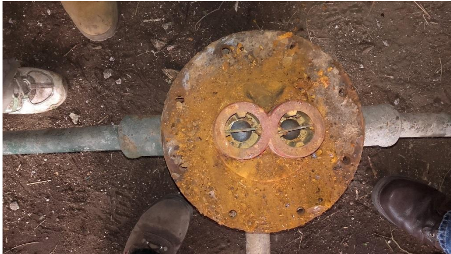
Figura 72. Fotografía de daños en los cilindros de los cheques parte superior
