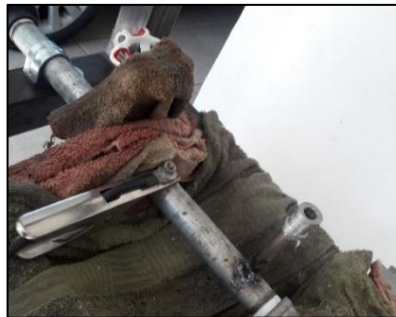
Figura 13. Soldadura de niple y copla para manómetro de descarga de la bomba
