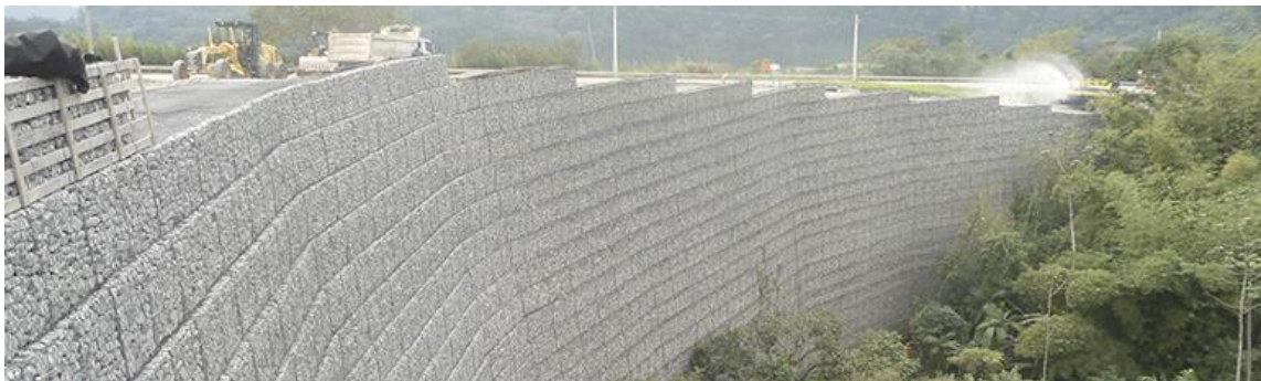
Figura 6. Fachada de malla metálica de doble torsión forrada en PVC
