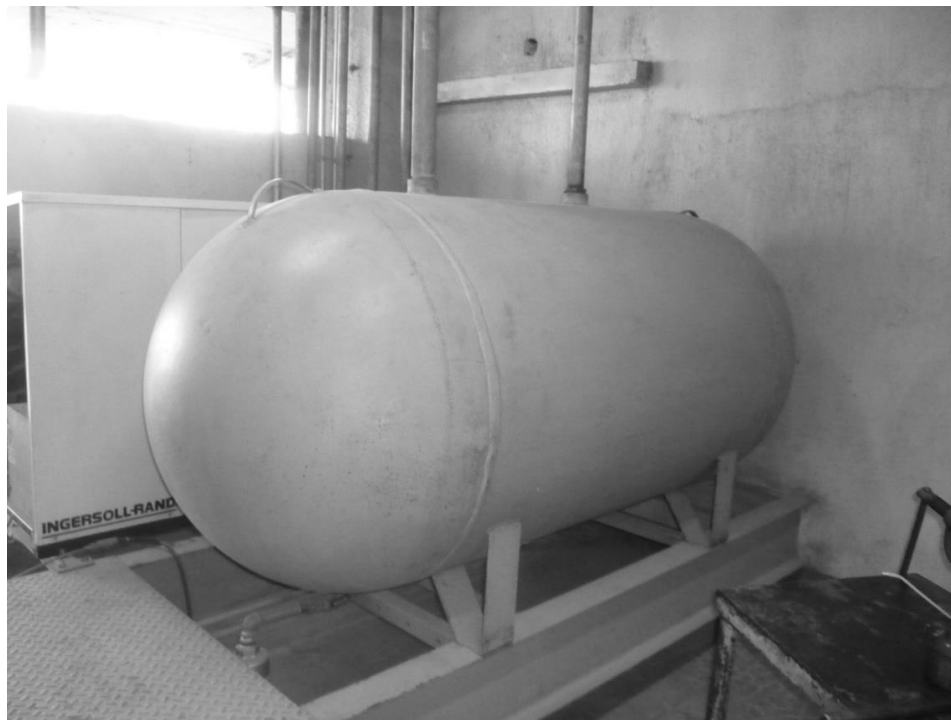
Figura 13. Tanque de almacenamiento instalado de IHNSA
