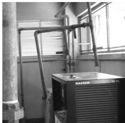
Figura 136. Tuberías y accesorios en la instalación actual de aire comprimido
