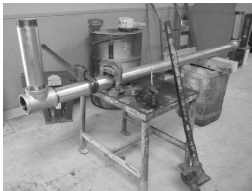
Figura 132. Tuberías y accesorios en la instalación actual
