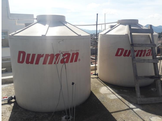
Figura 23. Depósitos de agua
