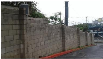
MURO PERIMETRAL DE BLOCK CON CIMENTACIÓN DE CONCRETO ARMADO Y PINES DE REFUERZO VERTICAL, CON ACABADO DE BLOCK VISTO, UTILIZADO COMO CERRAMIENTO DE LADO SUR DEL SITIO POR INTERVENIR.
