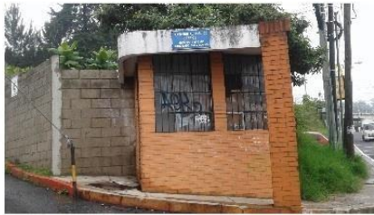
GARITA ABANDONADA, DE PEAJE VEHICULAR, DE CONCRETO ARMADO CON ACABADO FINAL DE FACHAleta DE LADRILLO, CON PUERTA DE METAL Y VENTANAS DE VIDRIO CON MARCOS DE METAL, CON BARROTES DE TUBO CUADRADO DE 3/8 DE PLG. CUENTA CON LOS MATERIALES DE CONSTRUCCIÓN EN BUEN ESTADO, CON POSIBILIDAD DE RECUPERACIÓN PARA REMODELACIÓN Y USO CON MANTENIMIENTO A FUTURO.
