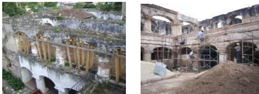
Figura 50. Fallas y arreglos en columnas dentro del convento
