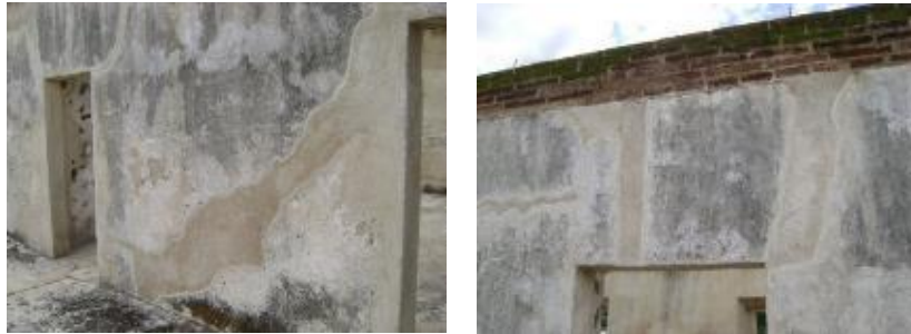
Figura 49. Fallas en muros en el convento
