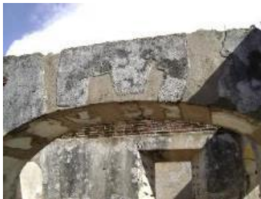
Figura 88. Falla por apertura de apoyos y coceo en arco
