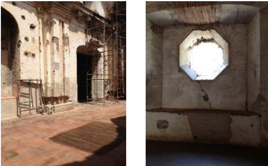
Figura 41. Agrietamiento y desprendimiento de material
