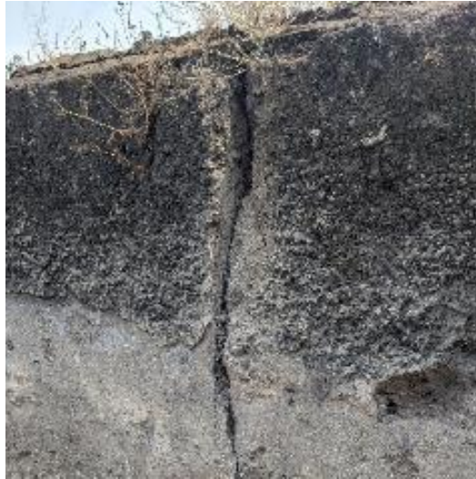
Figura 70. Grietas transversales en muro
