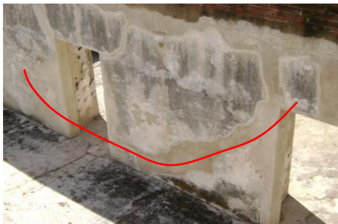
Figura 84. Línea de agrietamiento que evidencia falla por flexión en uno de los muros del segundo nivel
