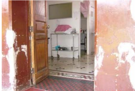
Figura 59. Deterioro en paredes dentro de la casa
