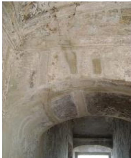
Figura 89. Falla por movimiento lateral de muros en bóveda
