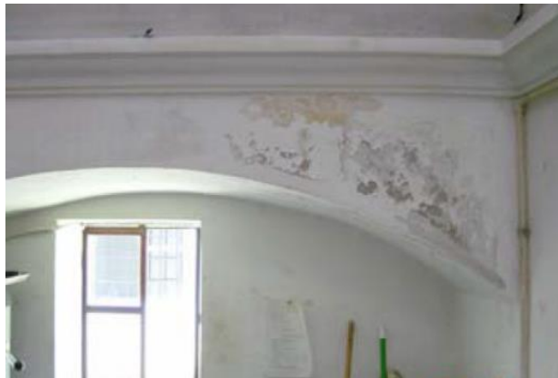
Figura 91. Deterioro en paredes de la Casa Fray Rodrigo de la Cruz
