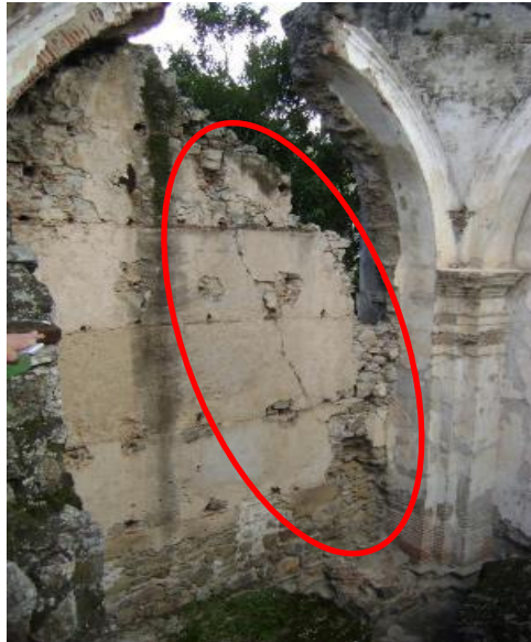
Figura 11. Falla cortante y desprendimiento del recubrimiento de un muro, Convento de Santa Teresa, La Antigua Guatemala
