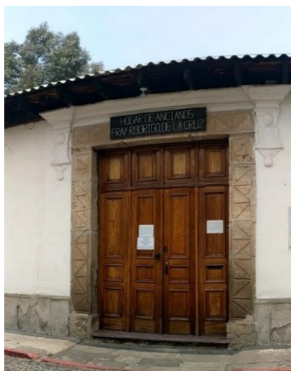
Figura 63. Dintel de roca en puerta principal
