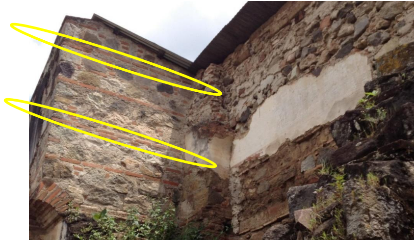
Figura 13. Rafas (hileras de ladrillo) en un muro, San José Catedral, La Antigua Guatemala
