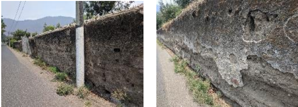
Figura 65. Deterioro en muros perimetrales
