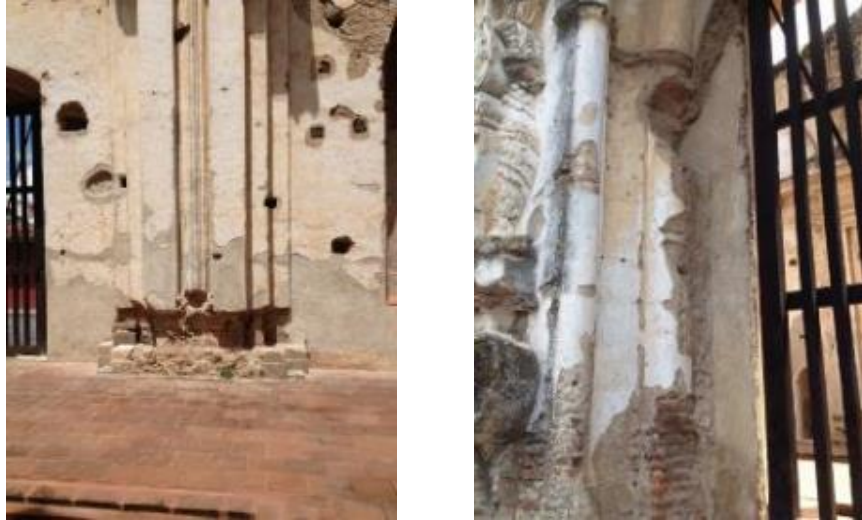
Figura 38. Desprendimiento de material, Santa Clara
