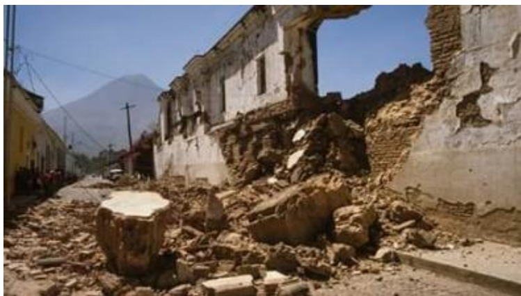
Figura 35. Colapso de muro en Antigua Guatemala, lado oriente del Palacio de los Capitanes Generales
