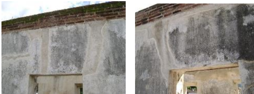
Figura 86. Agrietamiento por concentración de esfuerzos en vanos
