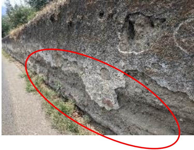
Figura 95. Daño por humedad en muro divisorio
