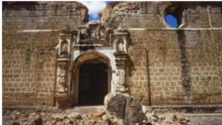
Figura 74. Colapso de la sección de una ventana, Templo de Santa Clara, La Antigua Guatemala, 1976
