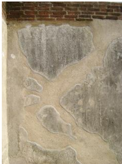
Figura 85. Evidencia de fallo por cortante y flexión
