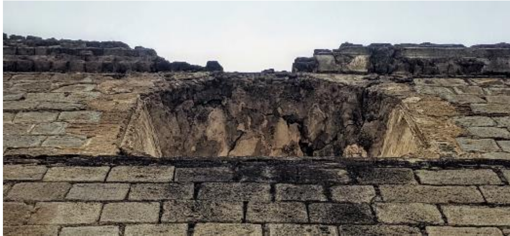
Figura 42. Agrietamiento en vano superior poniente
