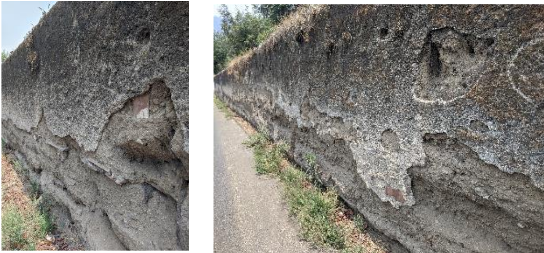
Figura 7. Muro construido con tapial, Carretera a San Bartolomé Becerra, La Antigua Guatemala
