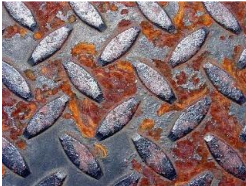
Figura 2. Óxido presente en una lámina de acero
