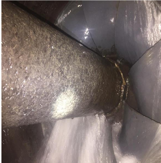
Figura 24. Prueba distribuidor turbina Francis
