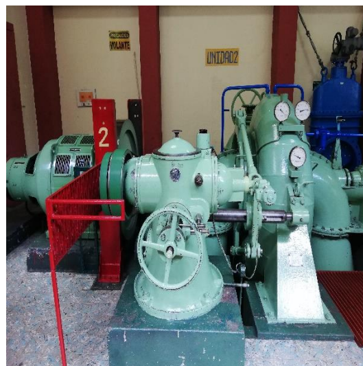
Figura 27. Regulador de velocidades turbina Francis
