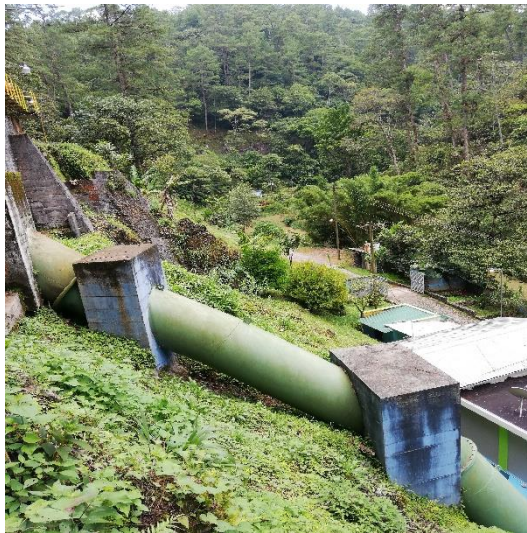
Figura 19. Tubería de presión hidroeléctrica Chichaic
