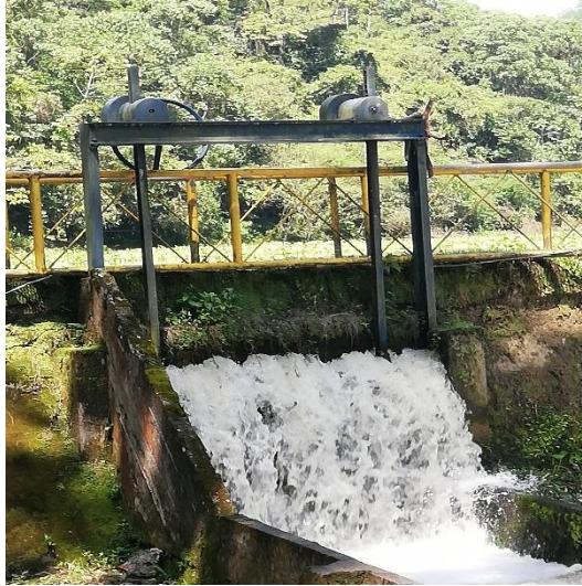
Figura 7. Compuerta de canal de conducción
