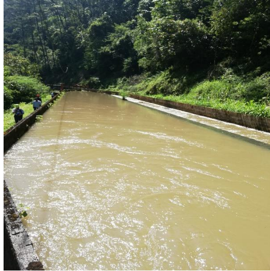
Figura 10. Desarenador hidroeléctrica Chichaic
