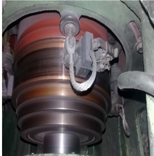
Figura 32. Escobillas, generador, hidroeléctrica Chichaic
