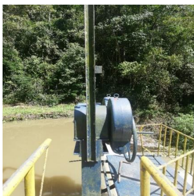
Figura 9. Mecanismo compuerta de descarga de fondo
