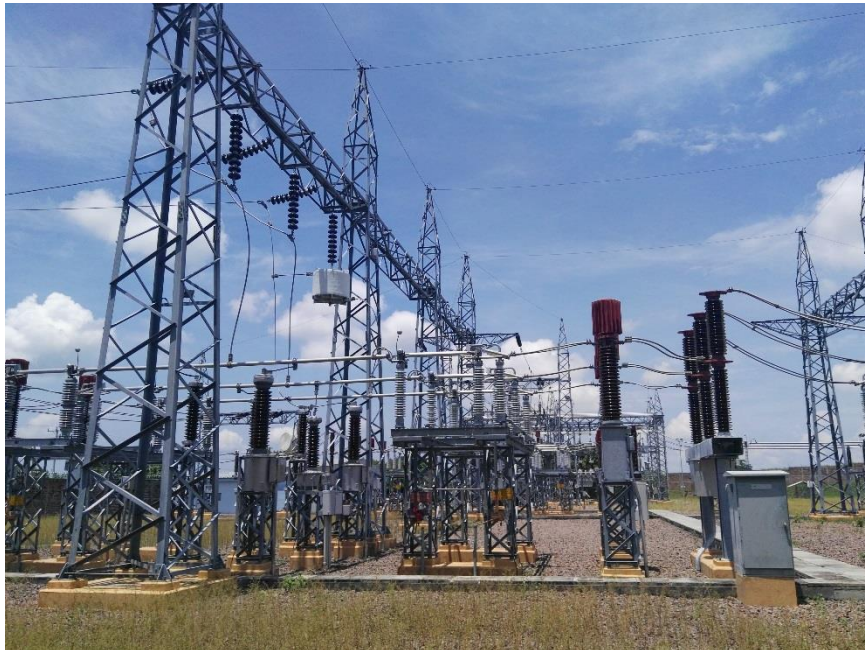
Figura 1. Subestación eléctrica de maniobra 115 KV
