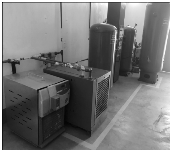
Figura 29. Cuarto de generación de nitrógeno
