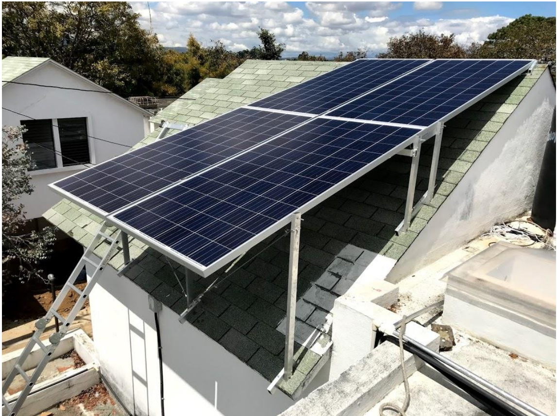
Figura 18. Imagen de los paneles fotovoltaicos sobre la estructura
