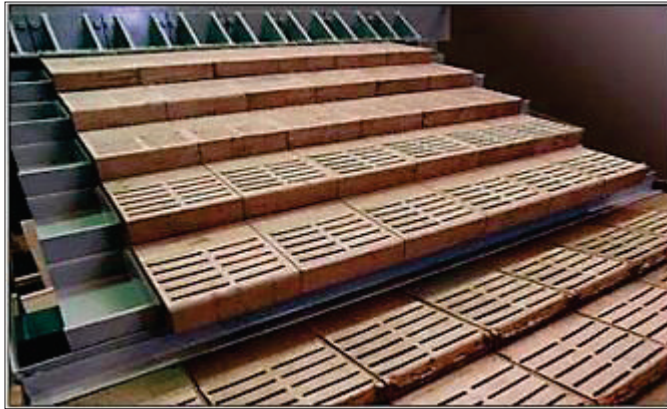
Figura 32. Líneas de parrillas en enfriador
