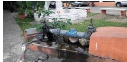
Figura 61. Acometida de agua, Fuente: elaboración propia.
