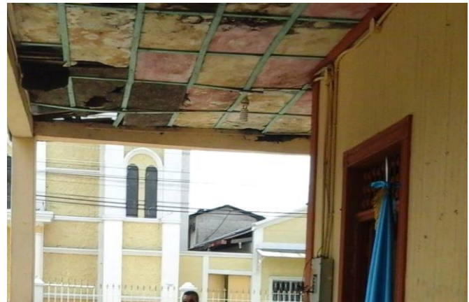
Figura 2. Daños en el cielo falso del frente del inmueble. Fuente: Facebook de la Municipalidad de San Francisco Zapotitlán.
