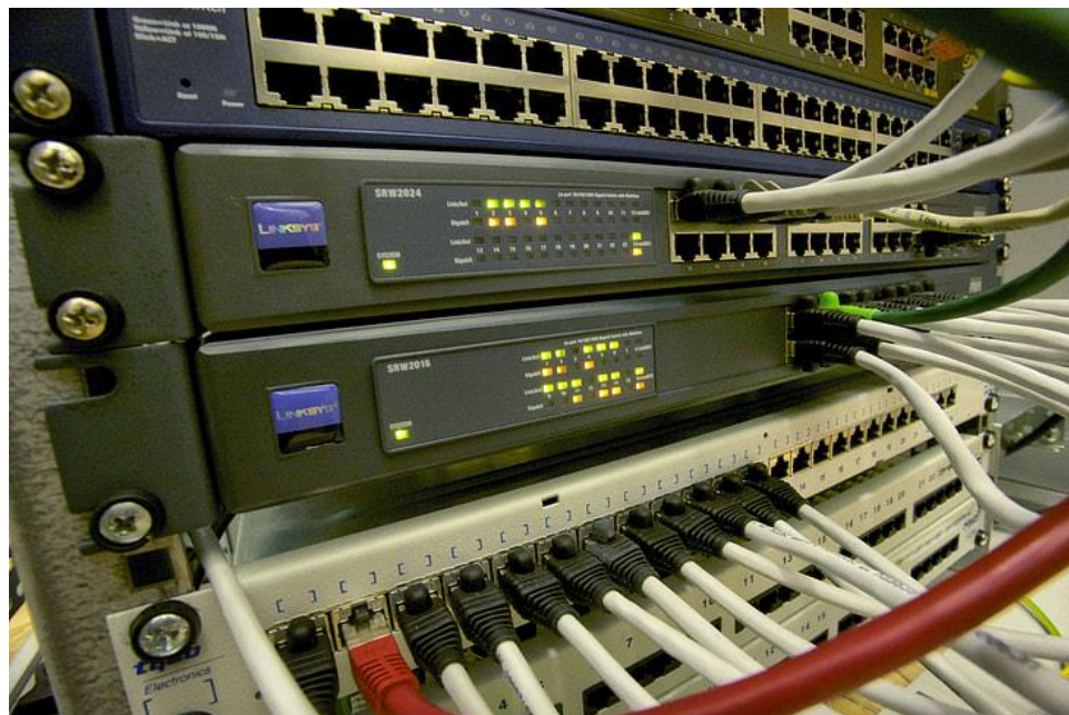
Figura 7. Equipos de red de comunicación
