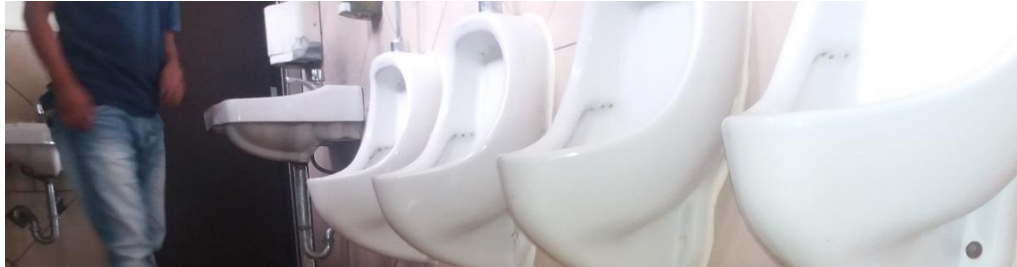
Figura 52. Inodoros y mingitorios de los sanitarios de la empresa
