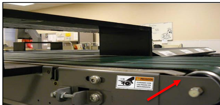
Figura 19. Zona de riesgo banda transportadora
