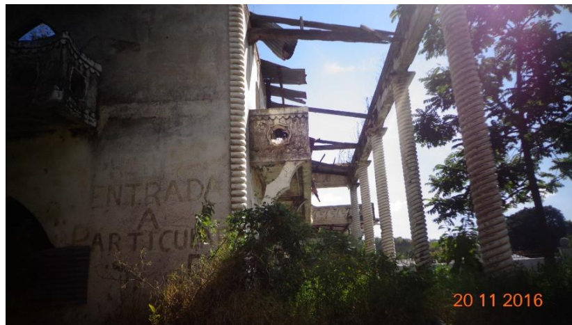
Figura 113. En la fotografía es posible observar el desplome total de la cubierta. Fuente: Velásquez Luna, 2016.
