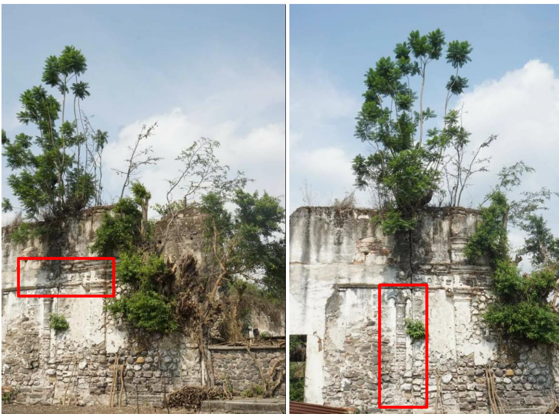
Figura 32. Vista de la fachada de la ermita en donde es posible algunos de los detalles decorativos en estucos, así como los daños causados por micro y macro flora en creciendo en sobre los muros. Fuente: Velásquez Luna, 2016.
