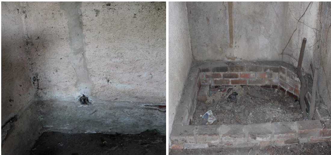
Figuras 99-100. Se observa que el muro fue alterado para instalar el sistema de electricidad, y sellado con cemento, la fotografía “B” muestra parte de los servicios sanitarios (ducha) que nunca fue terminado. Fuente: propia 2018
