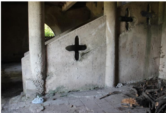
Figura 3. Interior de la casa patronal que evidencian algunos de los daños como la pérdida del piso y desprendimientos del revestimiento original.
