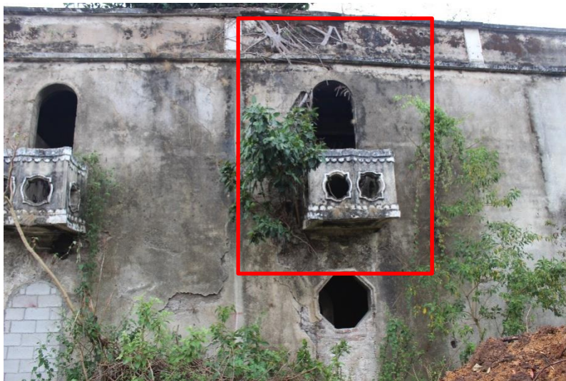
Figura 111. Se observan los daños que han sufrido los muros, disgregación de materiales por humedad y la presencia de microflora y macroflora. Fuente: Velásquez Luna, 2018.
