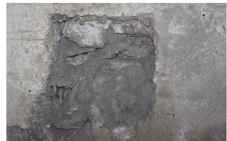
Figura 76. Oquedad en el muro que permite observar el cimienta a base de piedra. Fuente: Velásquez Luna, 2016.
