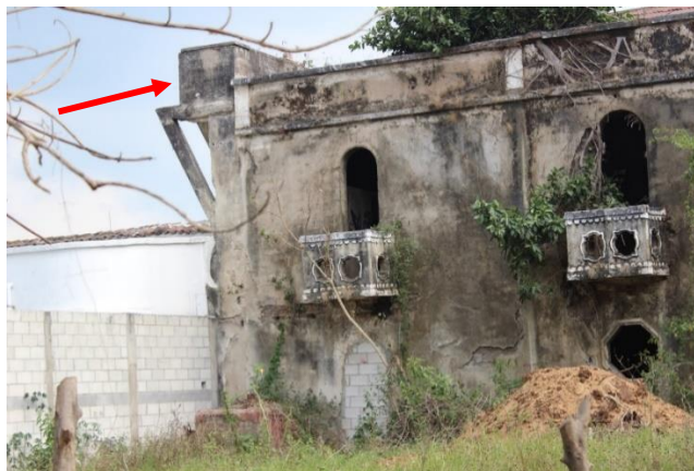
Figura 109. Vista de algunos vanos de ventana transformando en vanos de puerta, que fueron que posteriormente fueron tapiados con material del block. La flecha indica también construcciones intrusivas al inmueble como la construcción de tanque de agua construido con material de block. Fuente: Velásquez Luna, 2018.
