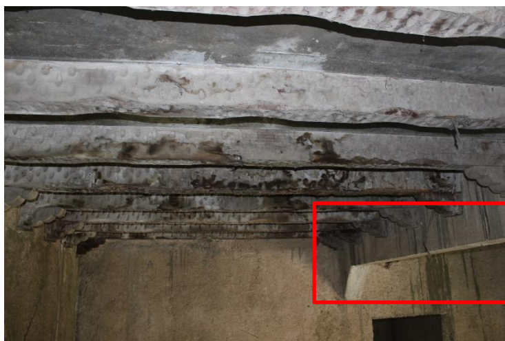
Figura 108. Entrepiso de cemento, el cuadrado en rojo muestra las vigas de concreto armado que están amarradas a columnas de concreto incrustadas sobre muros (tabiques) de block. En la fotografía es posible observar el artesanado de madera de pino, tallada y afectada posiblemente por la fundición del entrepiso de cemento. Fuente: Velásquez Luna, 2018.
