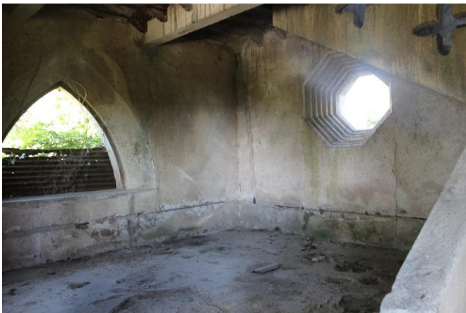
Figura 75. Desprendimiento del revestimiento en muro, permite ver expuesto el material constructivo, así como varillas de hierro intrusivas en el muro. Fuente: Velásquez Luna 2016.
