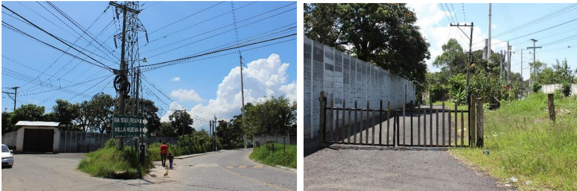
Figuras 17-18. Saturación de cables, postes eléctricos, y cableado telefónico, cercanos al ingreso del antiguo ingenio. Fuente: Velásquez Luna, 2019.
