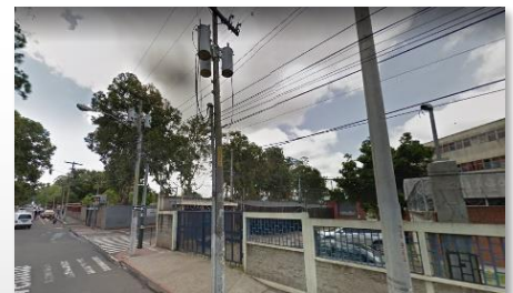
Figura 101. Acometida eléctrica en el CUM-USAC.
